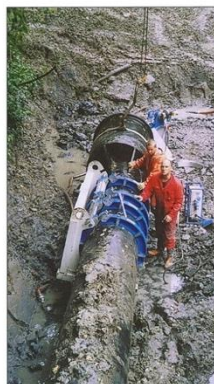
Bildet: Sammensveising av overgang 800 mm/1200 mm for bekkeinntaket ved Tvetenbekken. En "fuktig" jobb for Kristian Olimb AS.
