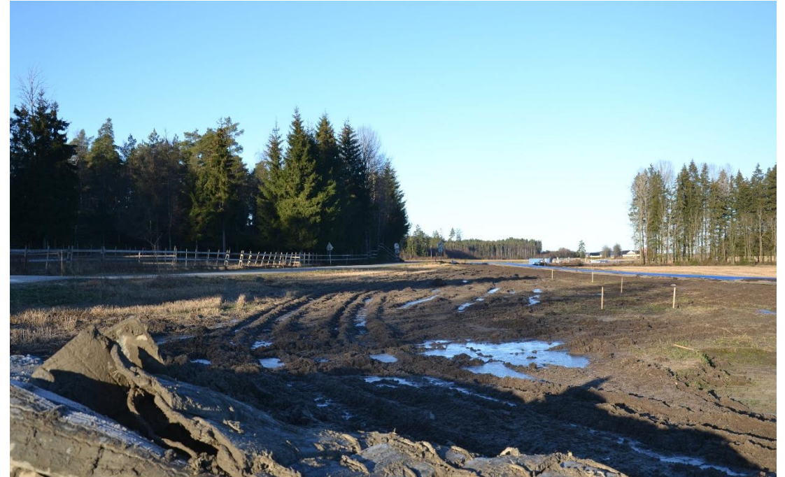
Omfattende kjøreskader i et prosjekt med styrt boring
