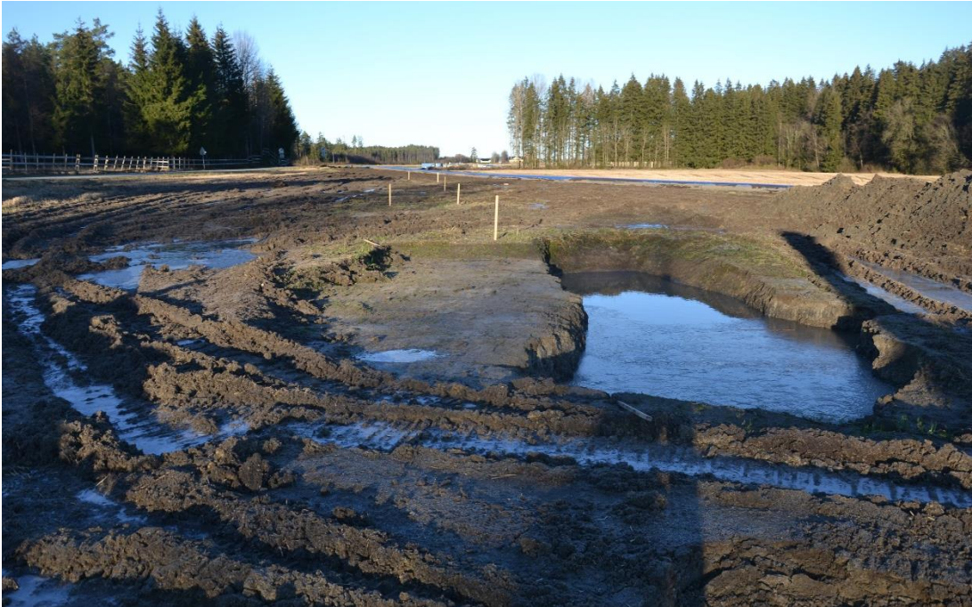
Høytstående grunnvannsnivå i prosjekt med styrt boring
